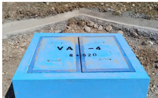
Identificación de las cámaras de Aire en las Líneas de Conducción Existente
