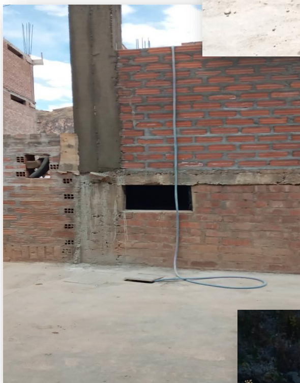
Hurto de agua en construcción ubicado en la Av. Andrés A. Cáceres Barrio de Yananaco
