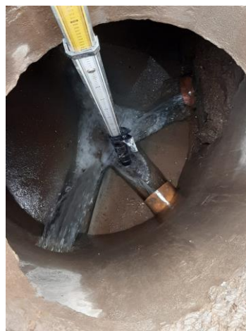
Identificación de Buzón (Buzón de Inspección)
