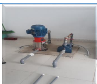
EQUIPOS DE ELECTROBOMBAS
