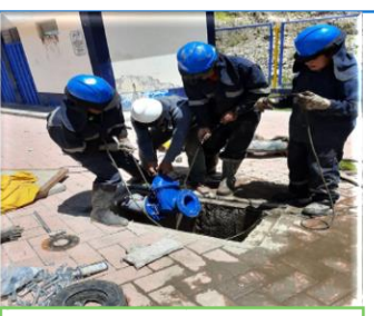
VALVULAS DE AIRE EN LA LINEA DE CONDUCCION MILLPO
