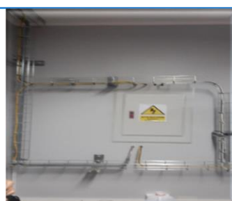
EQUIPOS DE TABLERO DE CONTROL
