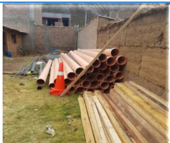
TUBERIAS PARA EL SISTEMA DE AGUA POTABLE Y ALCANTARILLADO
