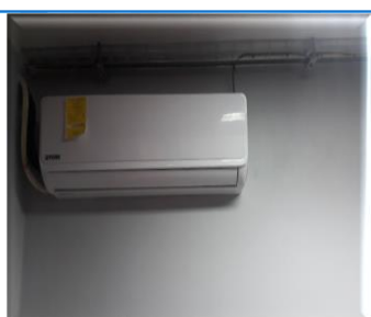
EQUIPO DE EQUIPAMIENTO PARA DATA CENTER
