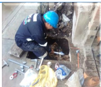
CAMBIO DE ACCESORIOS Y VALVULAS
