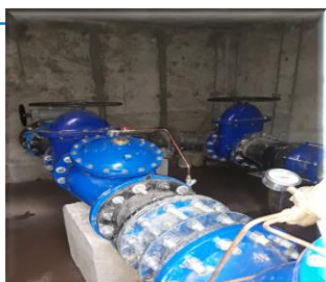
REPOSICION DE VALVULAS REDUCTORAS DE PRESION
